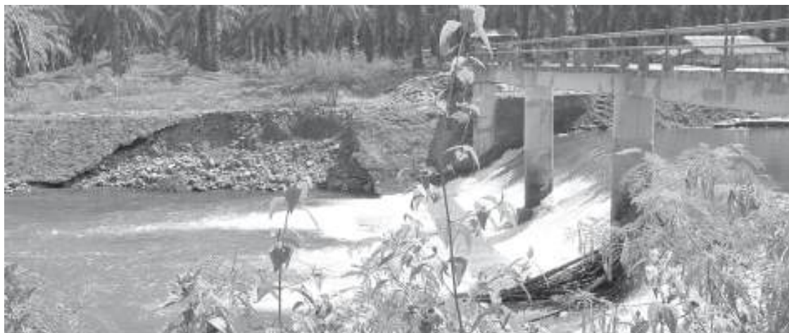
AMBLAS | Dinding beton pengaman tebing di sayap kanan dilihat dari kejauhan, terlihat jelas amblas dengan ngngga runtuhannya beton cukup lebar. (lukman)
